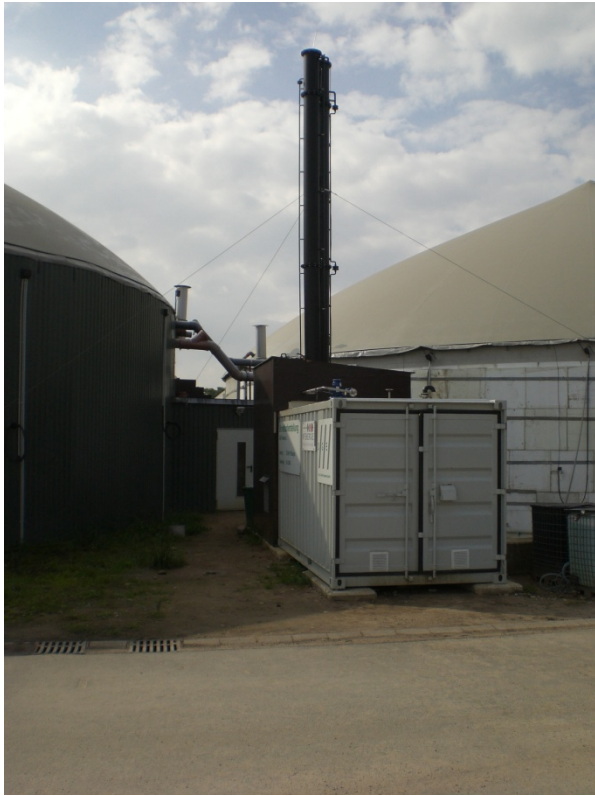
Kleinanlage 50 Nm 3 /h
